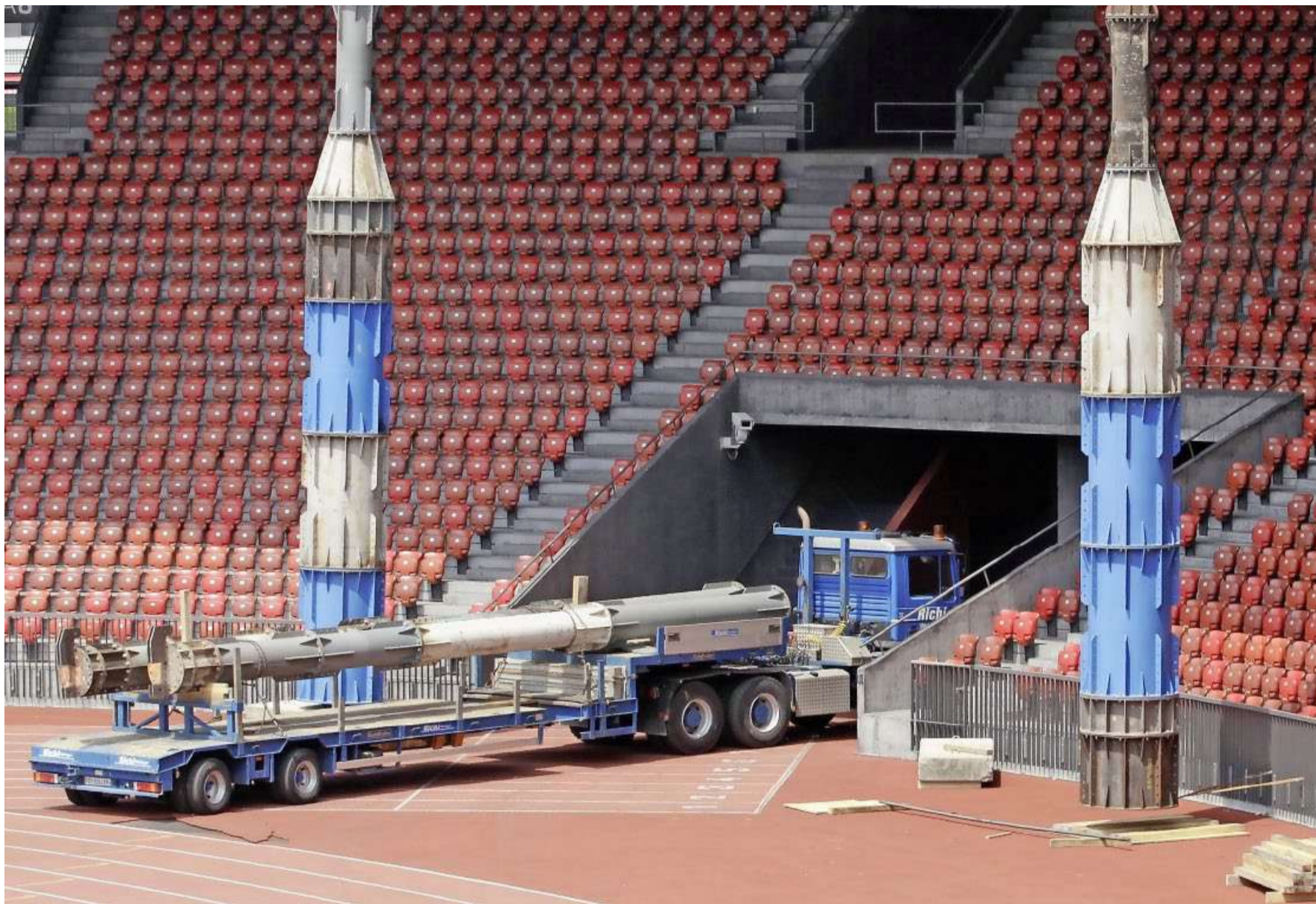
Einer der Streitpunkte: Schäden am Stadionsdach. Die Stadt liess 31 Notstützen aufbauen, reparierte die Dachträger und entfernte die Stützen dann wieder. Foto: Nicola Pitaro
